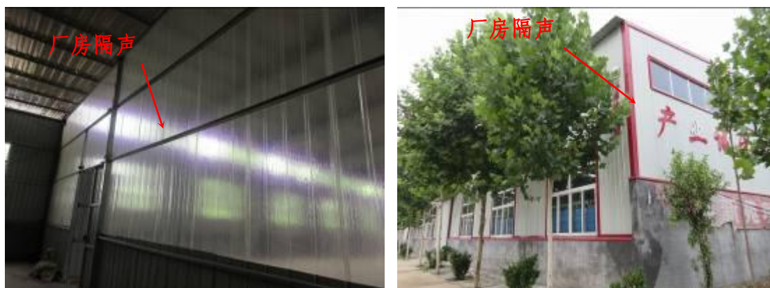
图 4-4 噪声治理设施落实情况
